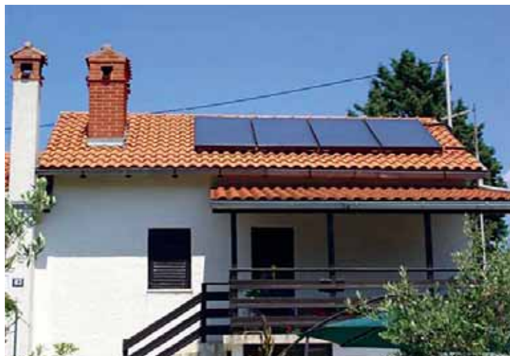
Slika 4. Primjer korištenja Sunčeve energije: sunčani toplinski kolektori
