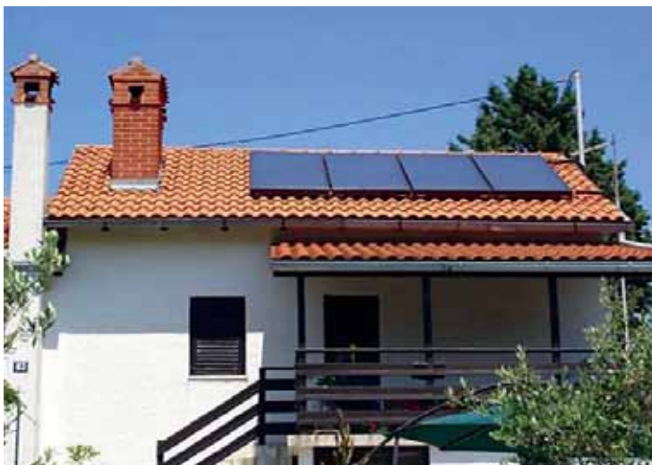
Slika 4. Primjer korištenja Sunčeve energije: sunčani toplinski kolektori
